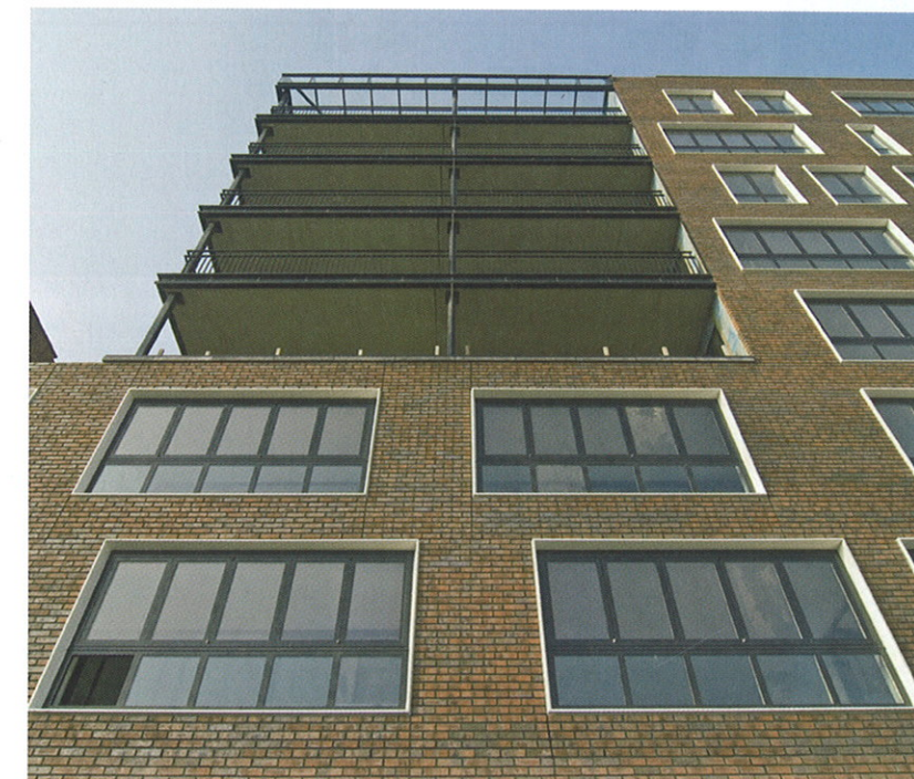
Omkaderde aluminium raampartijen van B. Mohrmann en Co, tegen de stalen balkonpartij van LBG Uift b.v. komen later ook aluminium raampartijen van Mohrmann
